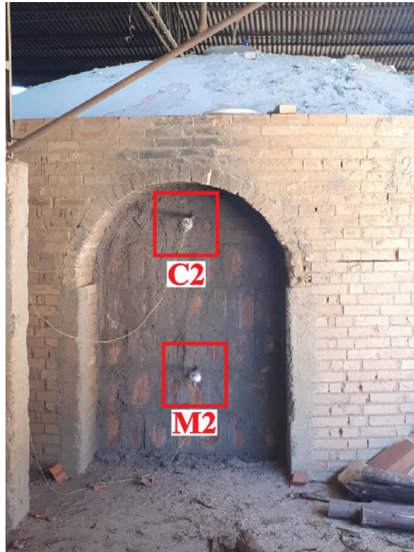
Figura 24- Termopares instalados na Porta 2 Fonte: Autor (2018)
