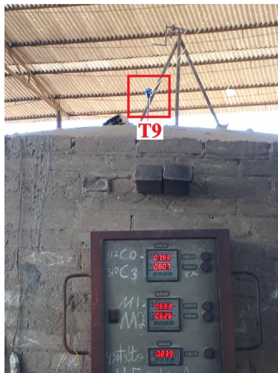
Figura 25- Termopar instalado no Topo da Abóboda Fonte: Autor (2018)
