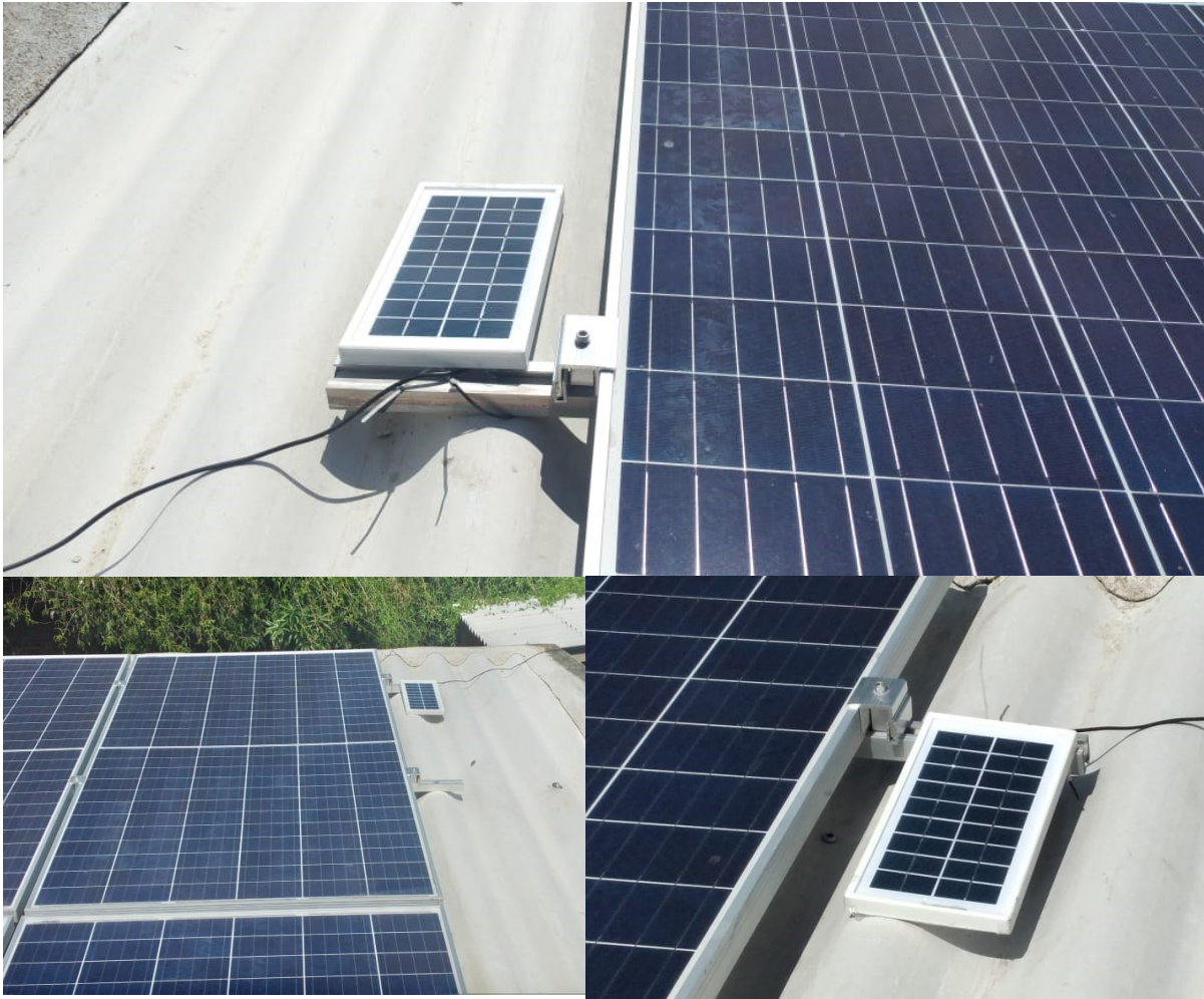
Figura 8: Placa fotovoltaica instalada. Fonte: Elaborado pelo autor (2021).
