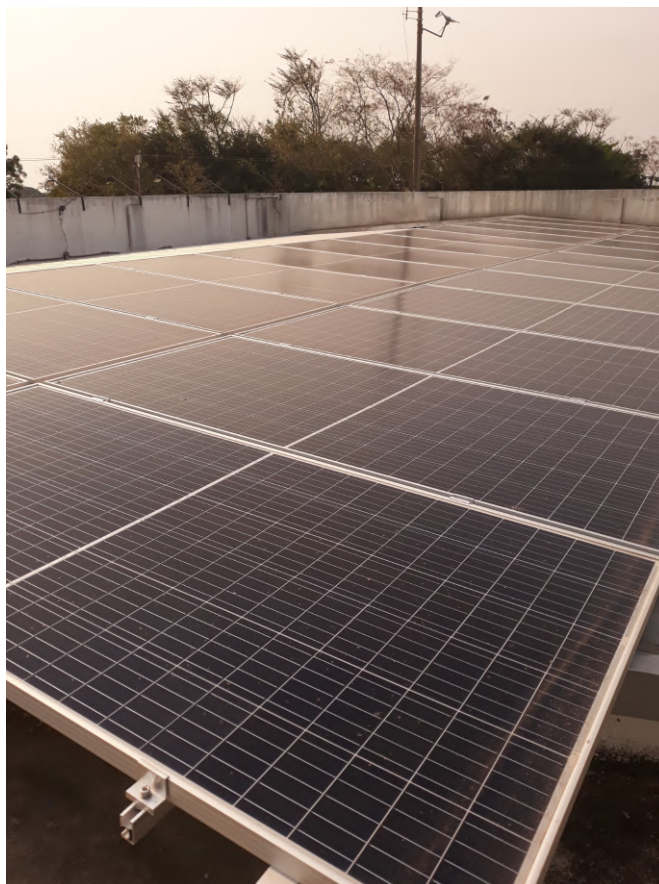
Figura 41 – Módulos fotovoltaicos no Polo de Inovação
