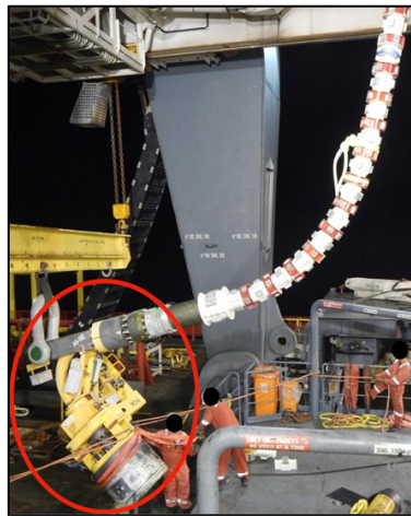
Figura 15: MCV conectado à linha de fluxo em um navio de lançamento de linha.
