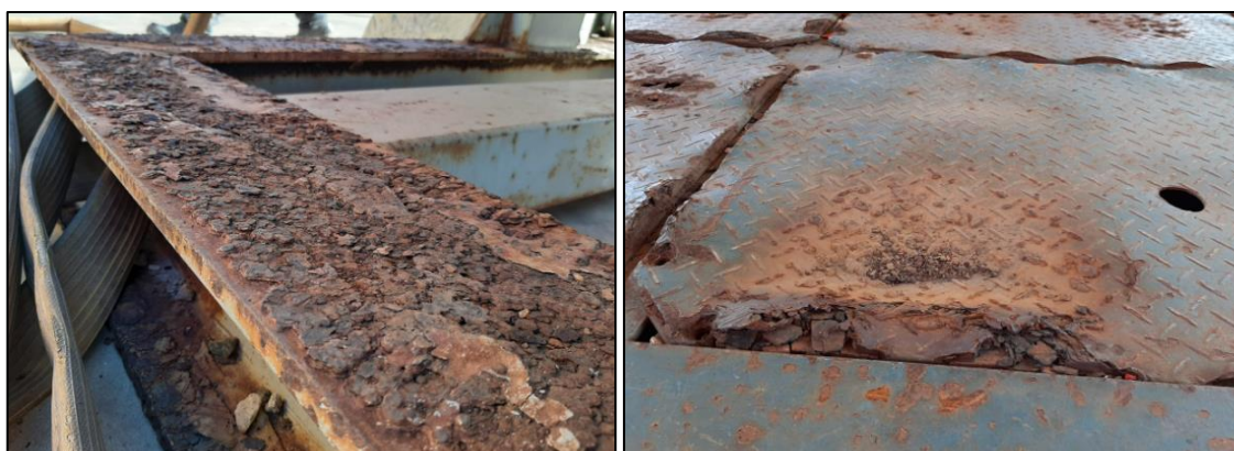
Figura 2. Perda evidente de matéria em estrutura metálica em empresa do Porto do Açu.
